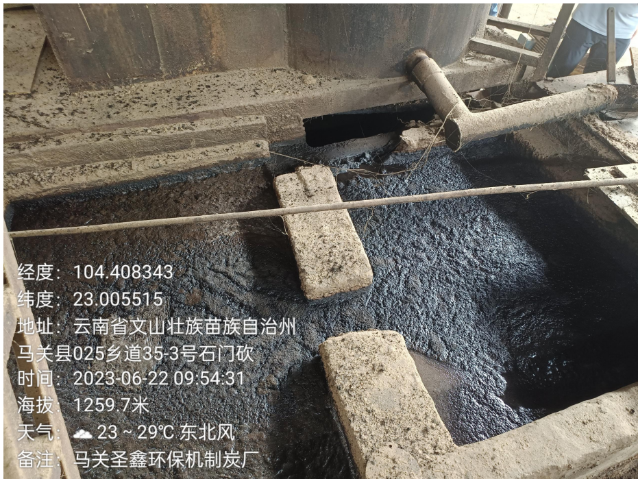
2. 马关圣鑫炭业发展有限责任公司水膜除尘设施循环水池情况；
